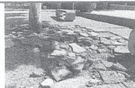
El estado del suelo es tan peligroso que se piden caídas de vecinos mayores.
